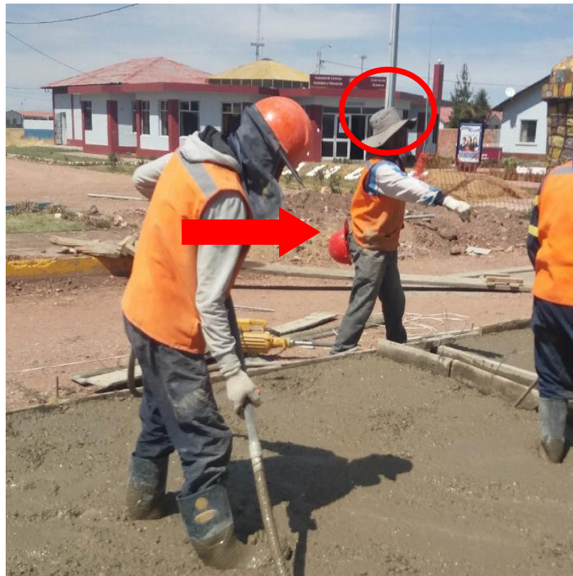
Figura 55: Se visualiza que por comodidad el obrero no usa el casco de seguridad de fecha 19 de setiembre.
