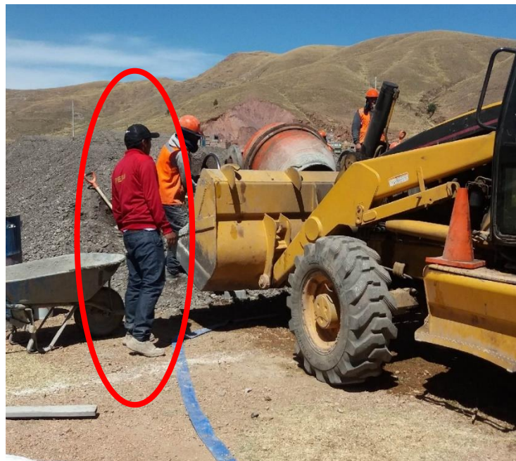
Figura 59: Se visualiza personal visitante en obra, sin uso equipos de protección personal.
