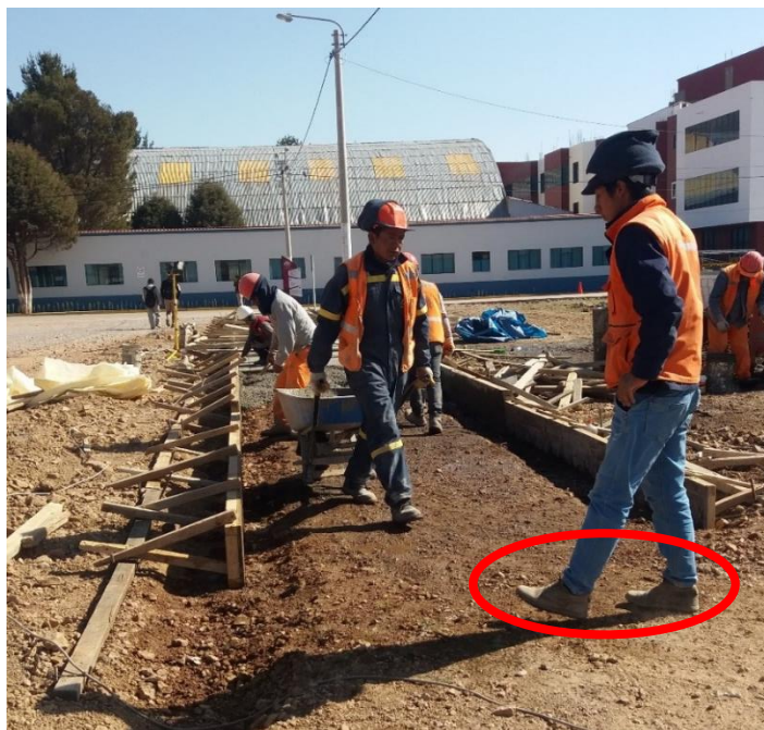
Figura 52: No se utilizan equipo de protección personal de seguridad de 4 de septiembre del 2018.
