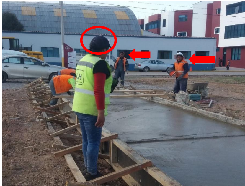
Figura 51: Se observa que los implementos de seguridad no se encuentran completos para todo el personal.
