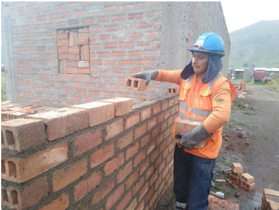
Imagen 63. Asentamiento de ladrillo de posición de soga
