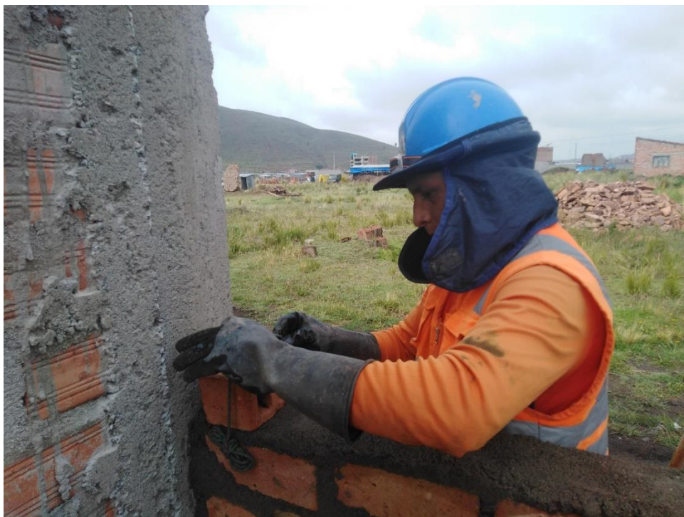
Imagen 41. Colocación de ladrillo con plomada para interceptar en la hilada del asentado.
