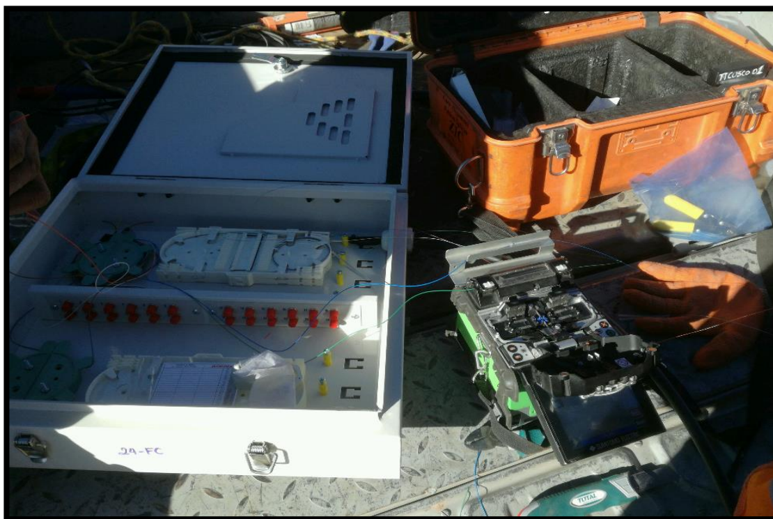
Figura 25 Fusión de fibra óptica.
