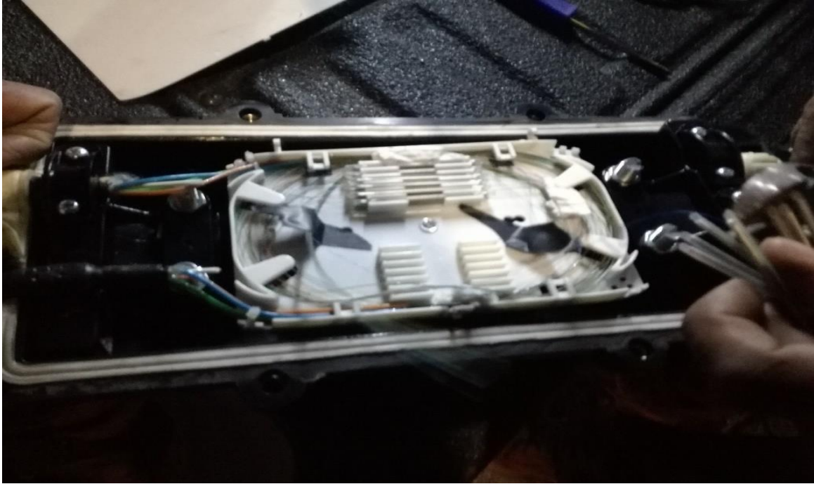
Empalme de hilos para el acceso a diferentes usuarios
