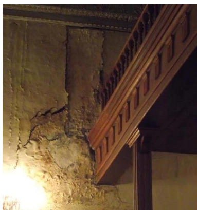
Figura 27. Unión entre el mezzanine y la pared. Se puede notar grietas y desprendimiento del revoque de la pared. Fuente: Grupo teatral Algovipasar
