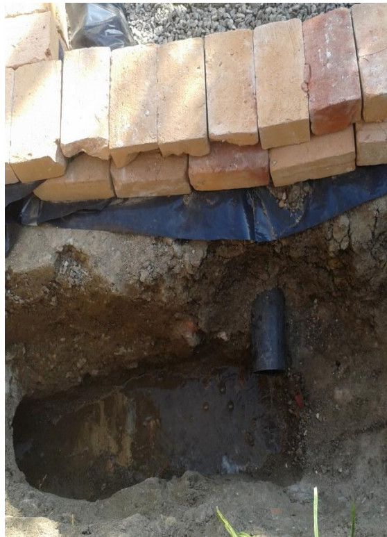
Figura 95. Salida del agua residual de todo el proceso de tratamiento
