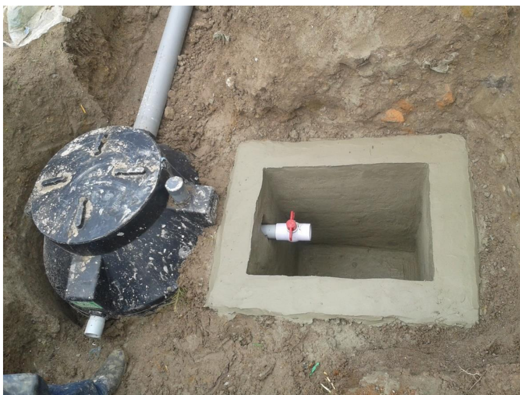
Figura 84. Cámara de lodos terminado
