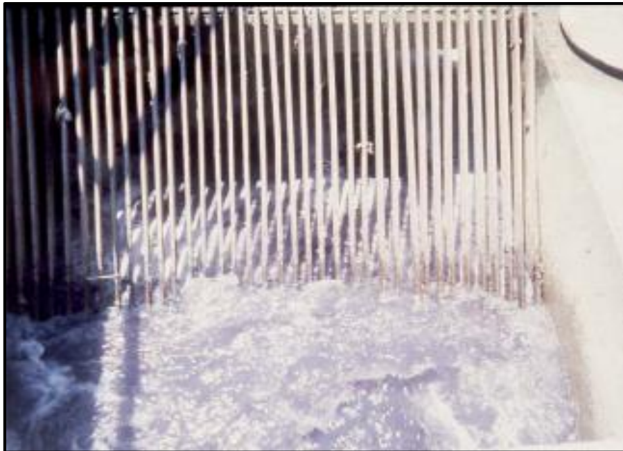
Figura 1. Cribas o cámara de rejas
