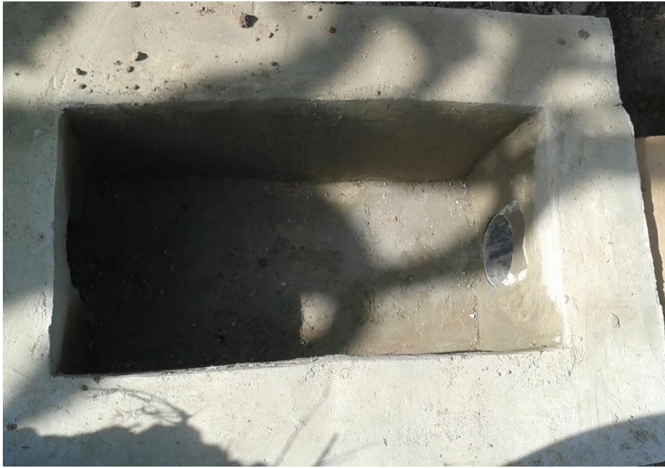
Figura 81. Cámara de registro terminado
