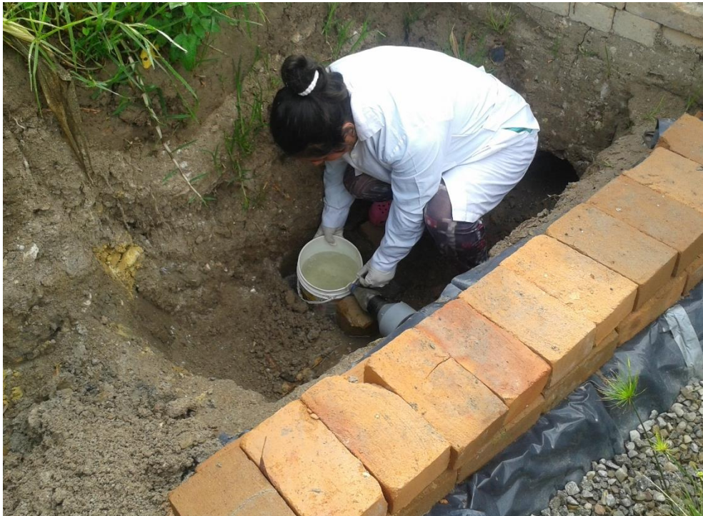
Figura 102. Toma del agua residual doméstica después de pasar por el sistema de tratamiento de HAFSH
