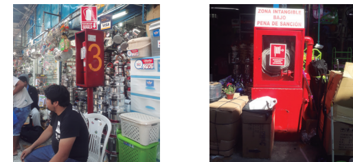
Imagen N° 34: Fotografía de un extintor general y una manguera contra incendios de la galería analizada en Jr. Puno 642
