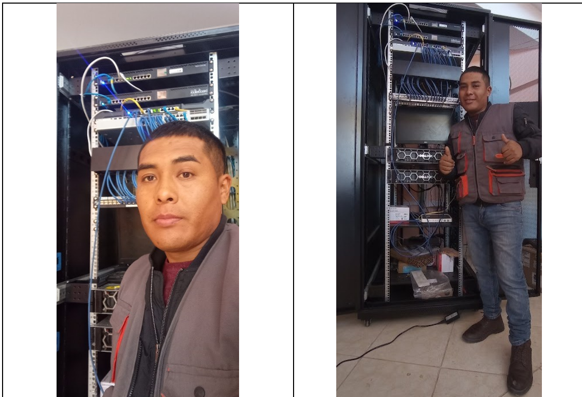
Figura 15. Sala de Data Center con racks, OLT y servidores.
