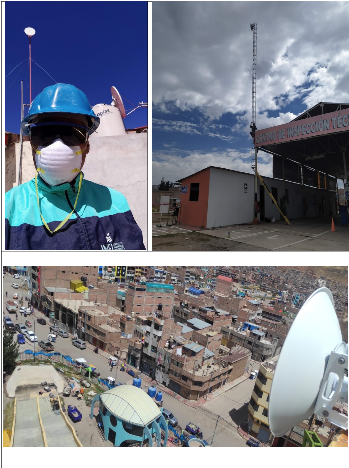
Figura 8. Configuración e instalación de antenas punto a punto en clientes empresariales.
