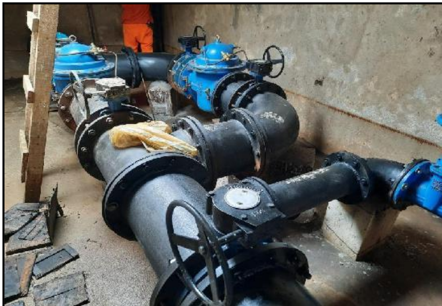
Figura N°13: Cámara de sectorización CS-01. Fuente: Elaboración Propia .
