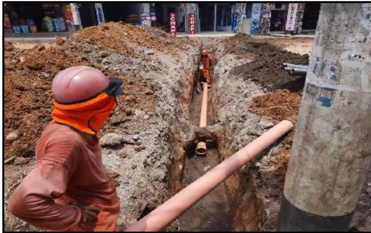
Figura N°19: Instalación de tubería PVC UF DN=160MM Serie 25. Para conexión de desagüe. Fuente: Elaboración Propia.
