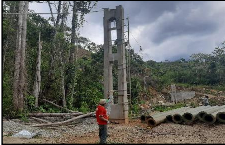
Figura N°09: Tuberías SCH-40 ASTM A-53 DN=14" para el cruce aéreo. Fuente: Elaboración Propia.
