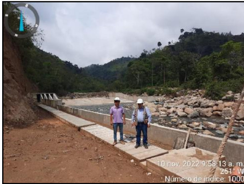
Figura 8 Captación río San Ramón Vilcabamba
