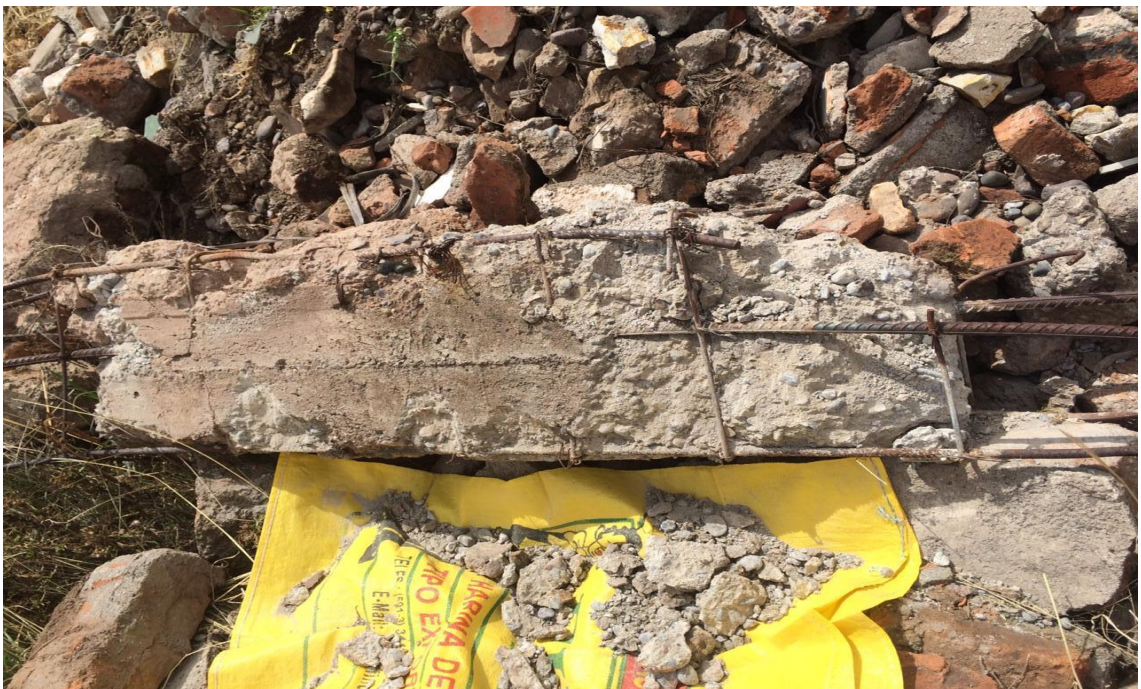
Fotografía 4. Escombros de columna
