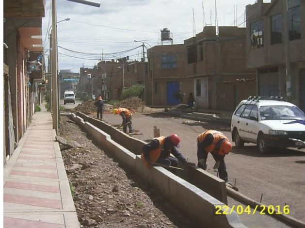
FOTOGRAFÍA N° 16. Encofrado para el colocado del concreto en cunetas Jr. Venezuela. Abril del 2016.
