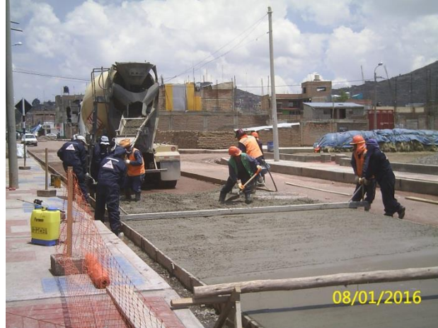
FOTOGRAFÍA N° 34. Colocado del concreto premezclado en el Jr. Huayna Roque C-3. Enero del 2016.
