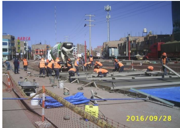
FOTOGRAFIA N° 43. Se al lado del pavimento rígido presencia de bolones (compuestos de fibra de acero y fibra de polipropileno) que fueron encontrados en el concreto. Septiembre 2016.
