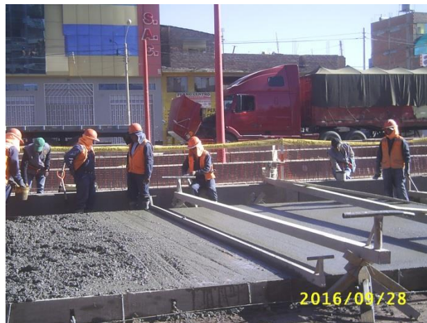
FOTOGRAFÍA Nª 44. Se observa en la parte posterior la medición que se realiza luego del vaciado de concreto del mixer.
