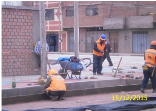
FOTOGRAFÍA N° 26. Encofrado para el colocado del concreto premezclado del siguiente carril Jr. 23 de Noviembre. Diciembre del 2015
