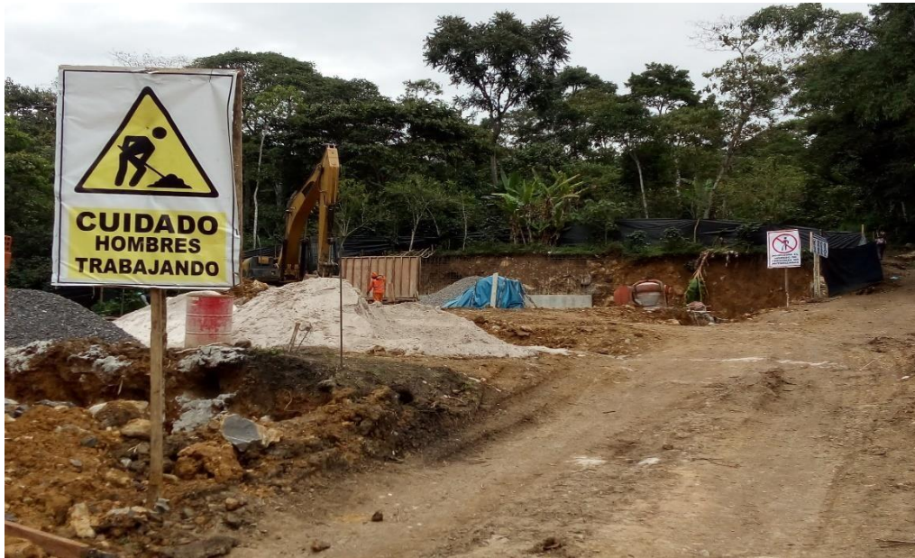
/ IMAGEN 01. Señalización en obra.
