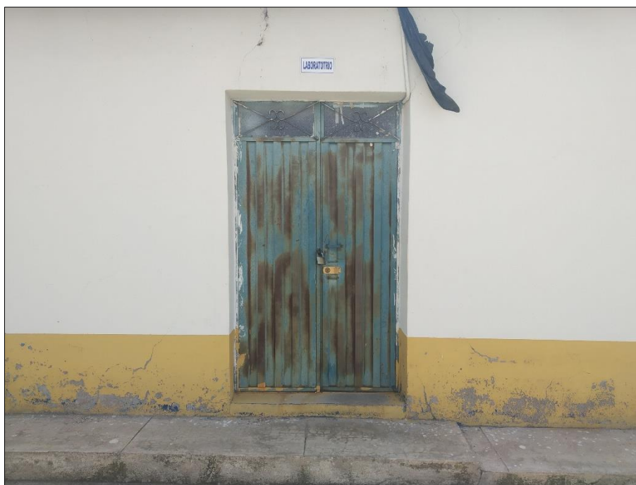
Figura 51. Puerta con presencia de corrosión - Laboratorio. (Elaboración propia).
