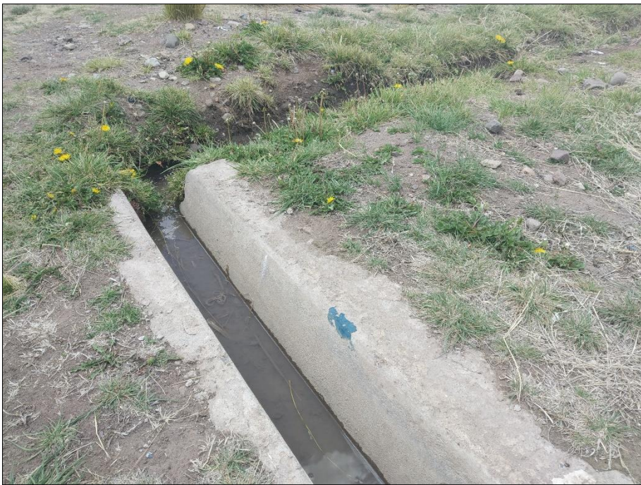
Figura 44. Canal obstruido y sin mantenimiento. (Elaboración propia).
