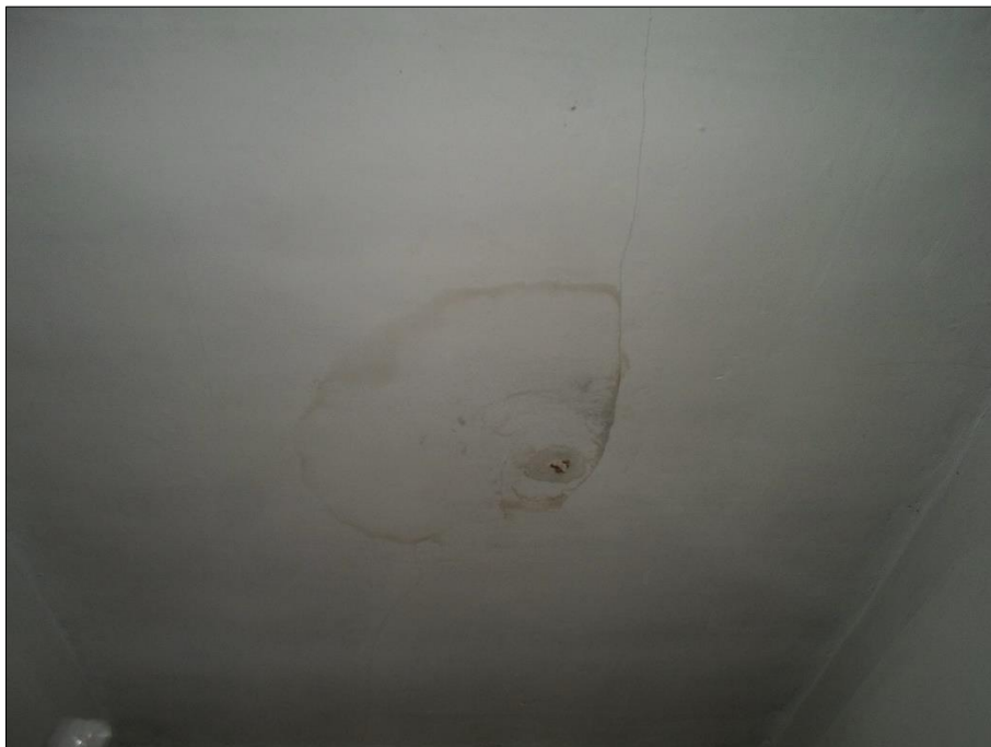
Figura 57. Presencia de humedad en el Cielo falso. (Elaboración propia).
