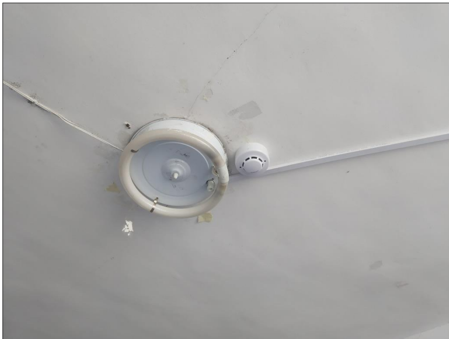
Figura 58. Sistema contra incendios (Sala de espera). (Elaboración propia).
