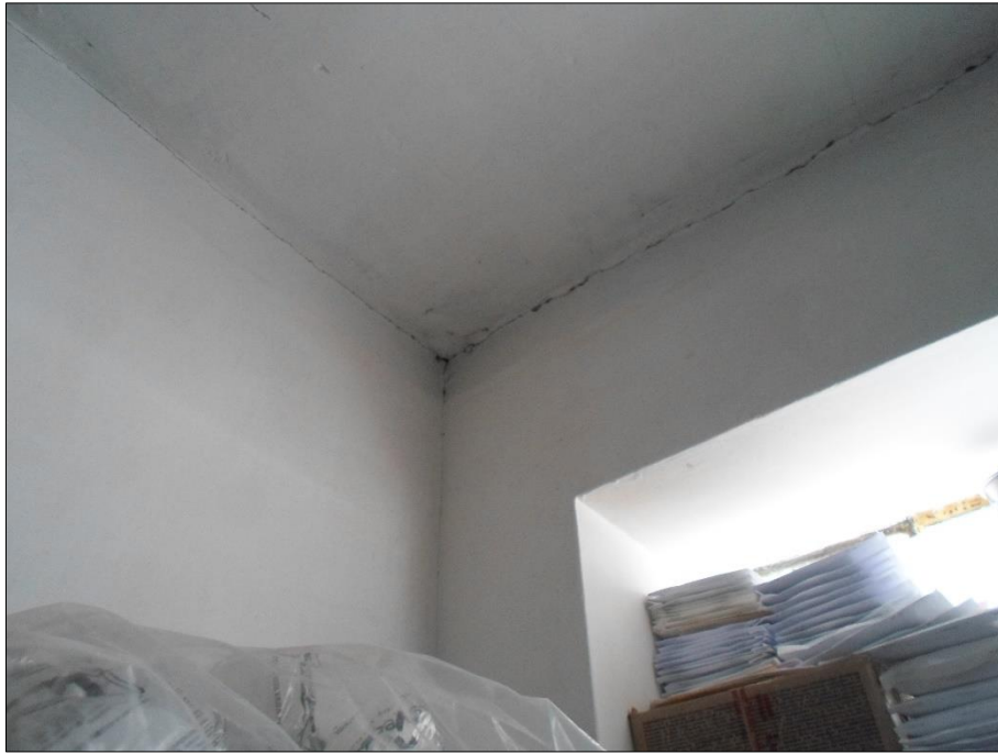
Figura 70. Presencia de fisuras horizontales en el Almacén. (Elaboración propia).
