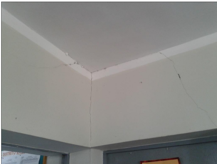
Figura 31. Grietas en conexiones, techo – muro. (Elaboración propia).
