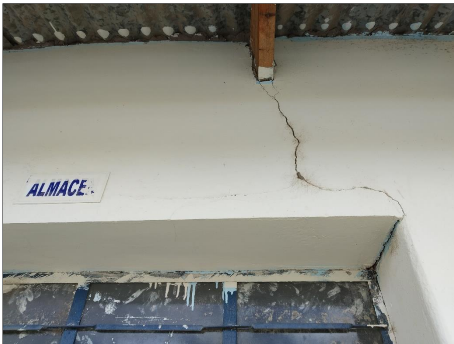
Figura 27. Falla vertical en muro portante. (Elaboración propia).
