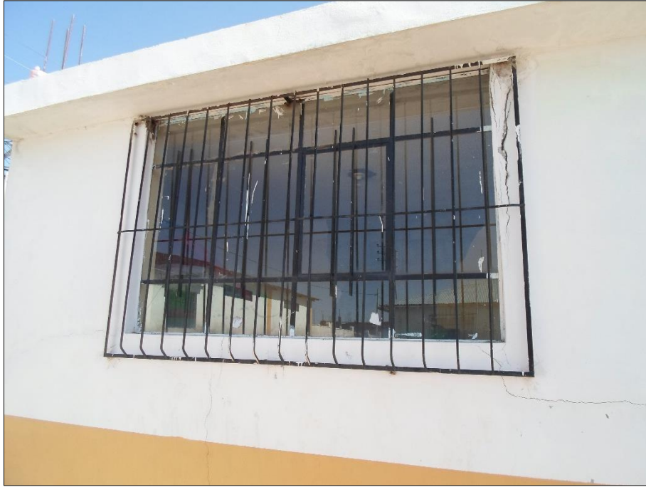
Figura 52. Presencia de grieta cerca a la ventana. (Elaboración propia).
