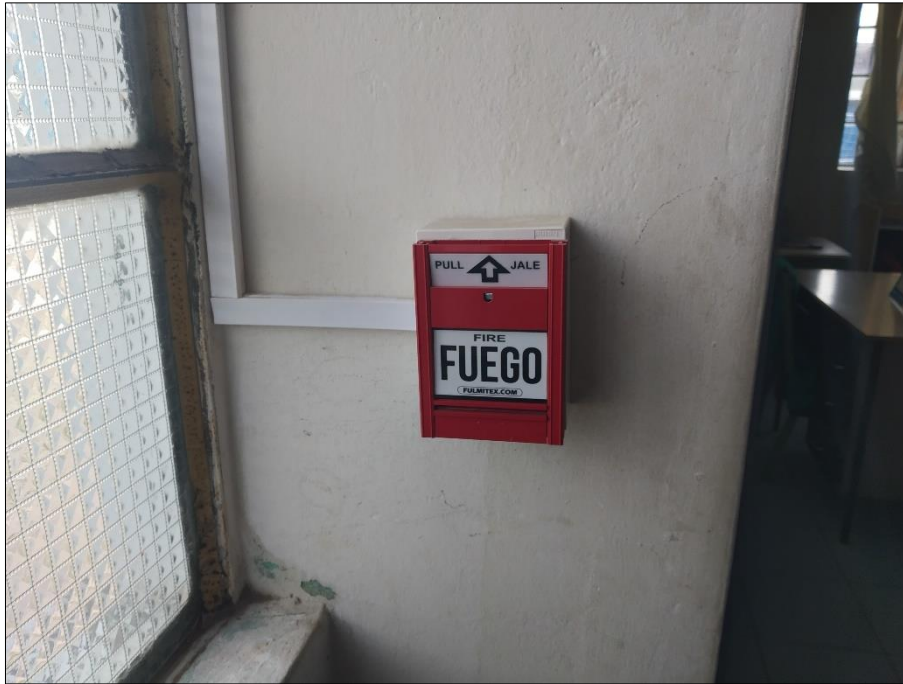
Figura 67. Sistema de alarma de contraincendios. (Elaboración propia).
