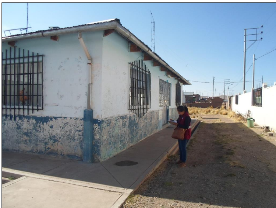
Figura 42. Canaleta con presencia de corrosión y sin mantenimiento. (Elaboración propia).
