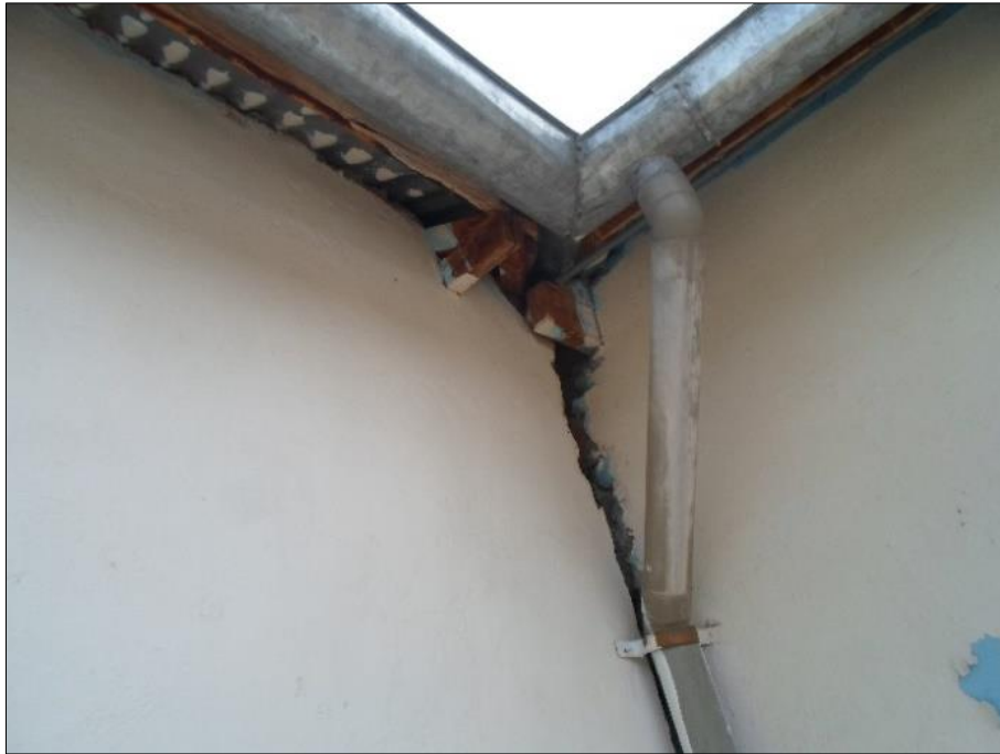
Figura 25. Presencia de grieta en uniones de los muros del Módulo II. (Elaboración propia).
