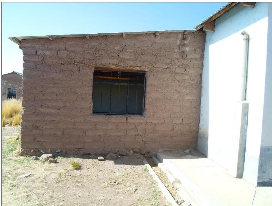
Figura 26. Nueva construcción sin junta de dilatación. (Elaboración propia).
