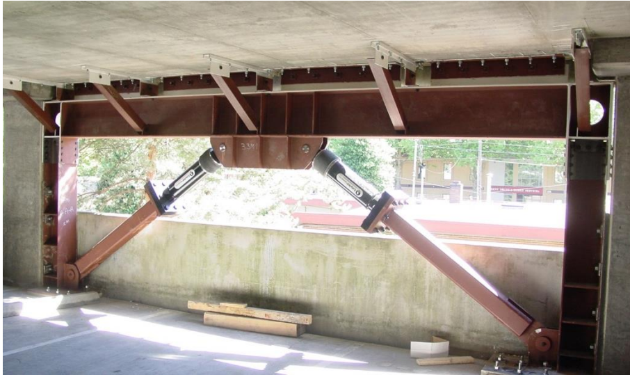
Figura 18. Colocación de los disipadores de fluido viscoso en arreglo chevron. Fuente:(Nuzzo et al., 2018).
