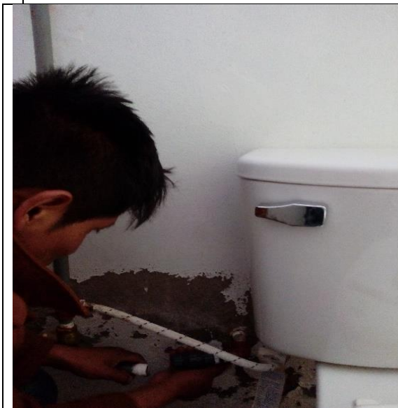
Instalación de accesorios para alimentar el inodoro tanto con agua gris y potable
