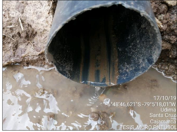
Foto 14. Evidencia de las aguas vertidas en la tubería de drenaje
