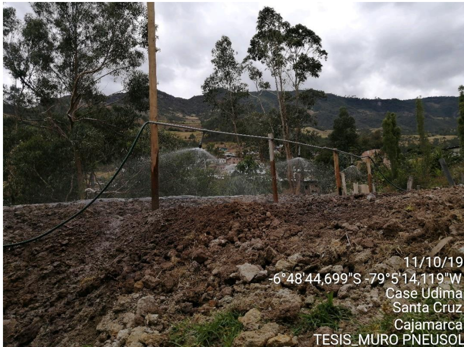
Foto 15. Saturación del relleno
