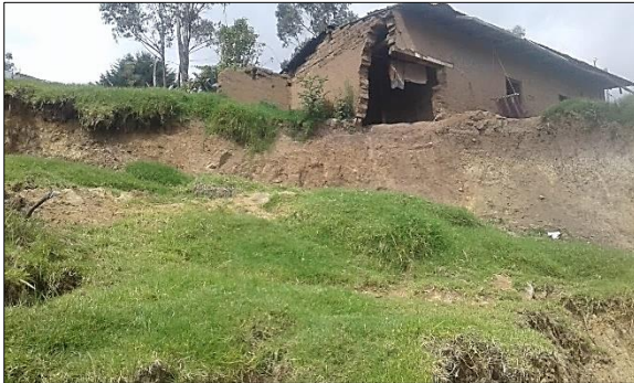
Foto 1. Ocurrencia de deslizamiento en el CP Udimá – Diciembre 2018
