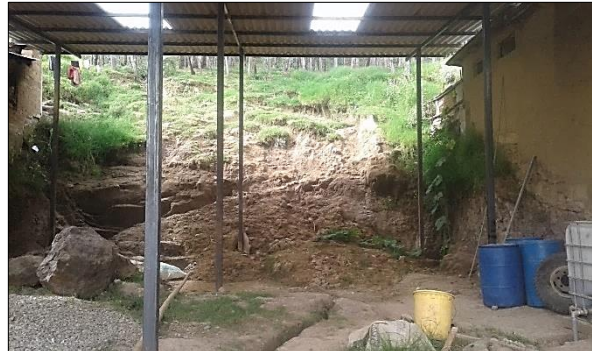
Foto 2. Ocurrencia de deslizamiento en el CP Udimá – Diciembre 2018
