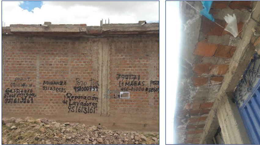
Fotografía 15. Eflorescencia en losas aligeradas.
