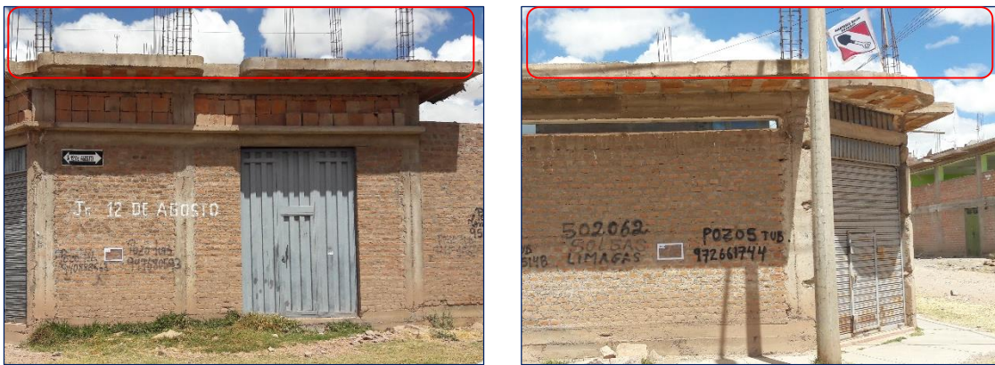
Fotografía 16. Aceros expuestos a presentar corrosión.
