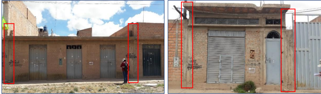
Figura 31. Viviendas sin juntas sísmicas en el distrito de San Miguel.
