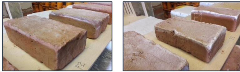
Figura 21. Unidades de albañilería con eflorescencia.
