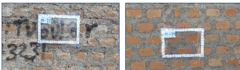
Figura 41. Calidad de juntas de mortero (adherencia arena-cemento).
