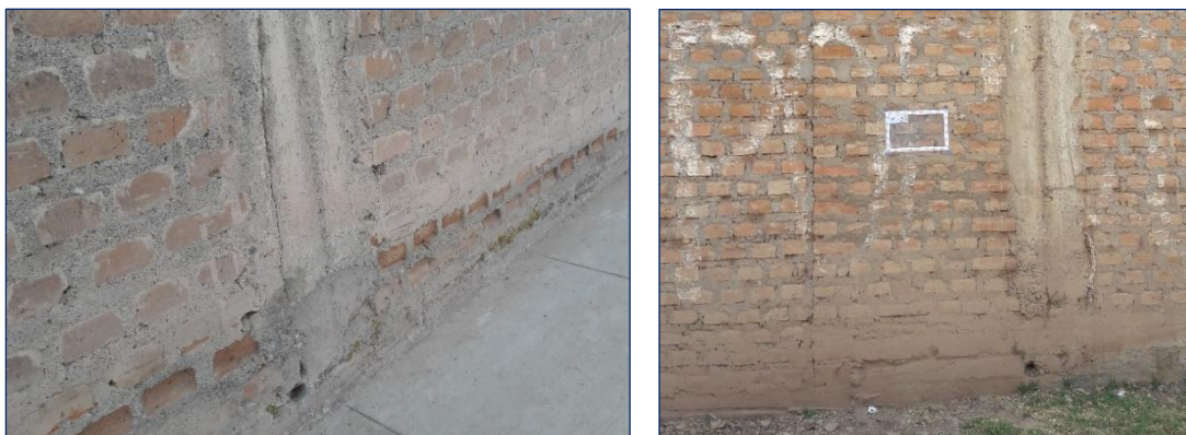
Fotografía 3. Tuberías de drenaje de aguas pluviales al costado y dentro de columnas de confinamiento.
