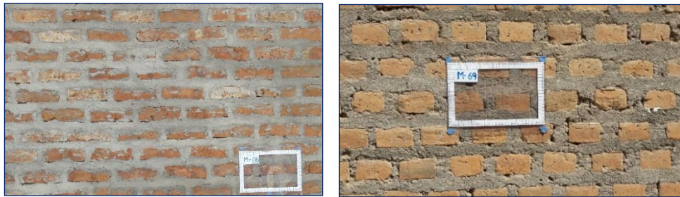
Figura 37. Eflorescencia y acabado superficial de unidades de albañilería en muros.
