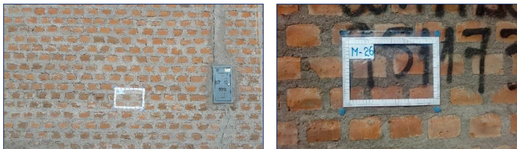
Figura 33. Muros construidos con unidades de albañilería de quemado no uniformes.
