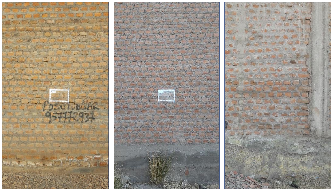
Fotografía 2. Presencia de salinidad en sobrecimientos de las viviendas analizadas.
