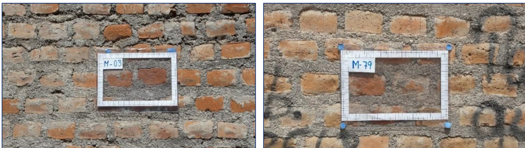
Figura 35. Variación dimensional en unidades de albañilería que conforman los muros.
