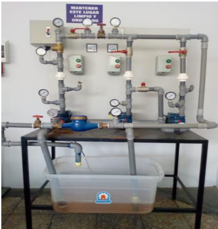
Figura 6: Banco de bombas en paralelo
