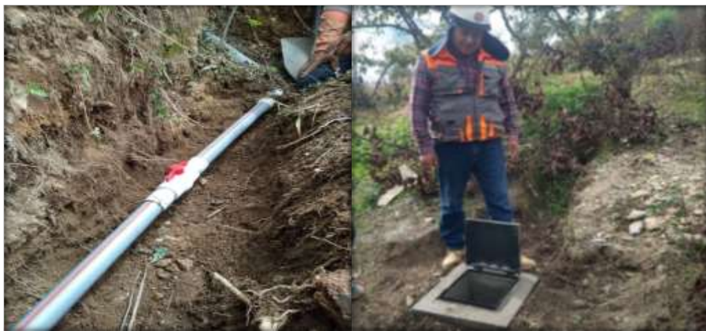
Figura N°32: Suministro de Válvula en los laterales.
