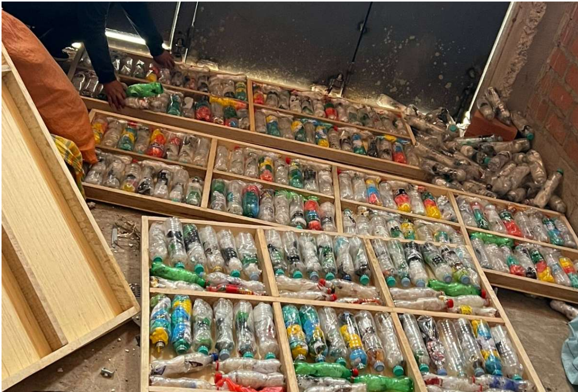
Fig. 8. Fotografías de barreras acústicas
