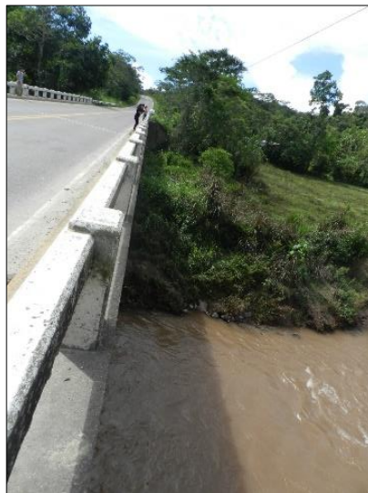
Fotografía 83. Puente vial y ribera deteriorada.
