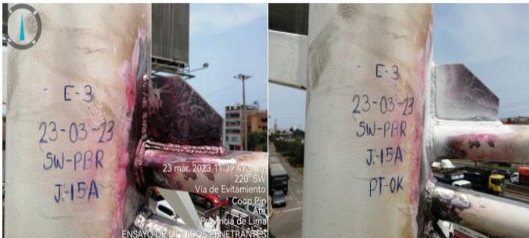
Figura N°102: Ensayo de líquido penetrante J-15A. Fuente: Elaboración propia.
