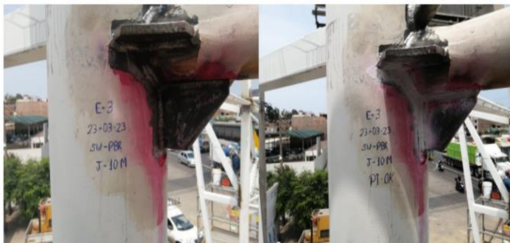
Figura N°103: Ensayo de líquido penetrante J-10M. Fuente: Elaboración propia.
