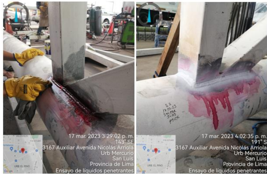
Figura N°72: Ensayo de líquido penetrante de puntales. Fuente: Elaboración Propia.
