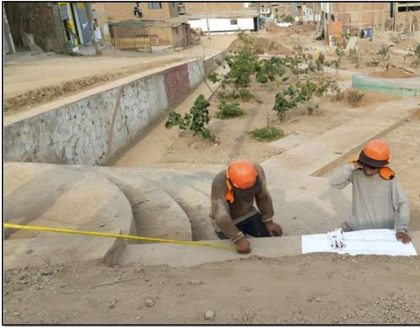
Figura N° 11: Replanteo en obra para informe de incompatibilidades Fuente: Elaboración Propia
