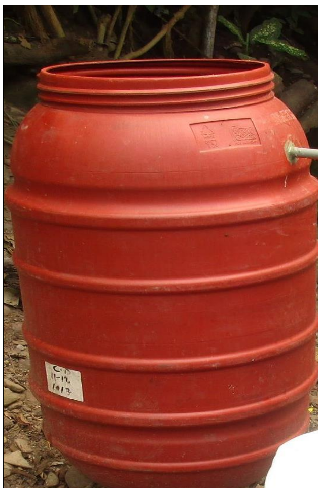
Figura 6. Filtro anaerobio Fuente: Elaboración propia, 2019
