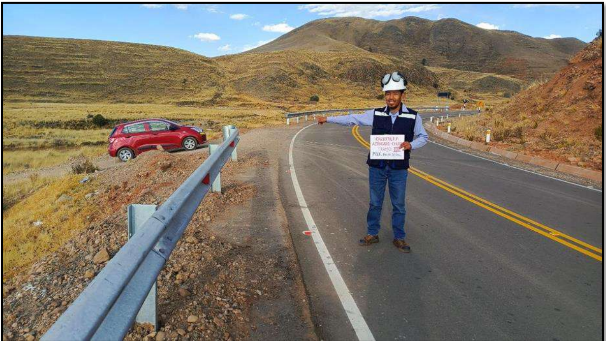
FOTOGRAFIA N° 14: EN LA IMAGEN SE MUESTRA LA AUSENCIA DE SEÑALIZACION DE PREVENCION (P-9B) EN LA PROGRESIVA 21+560.
