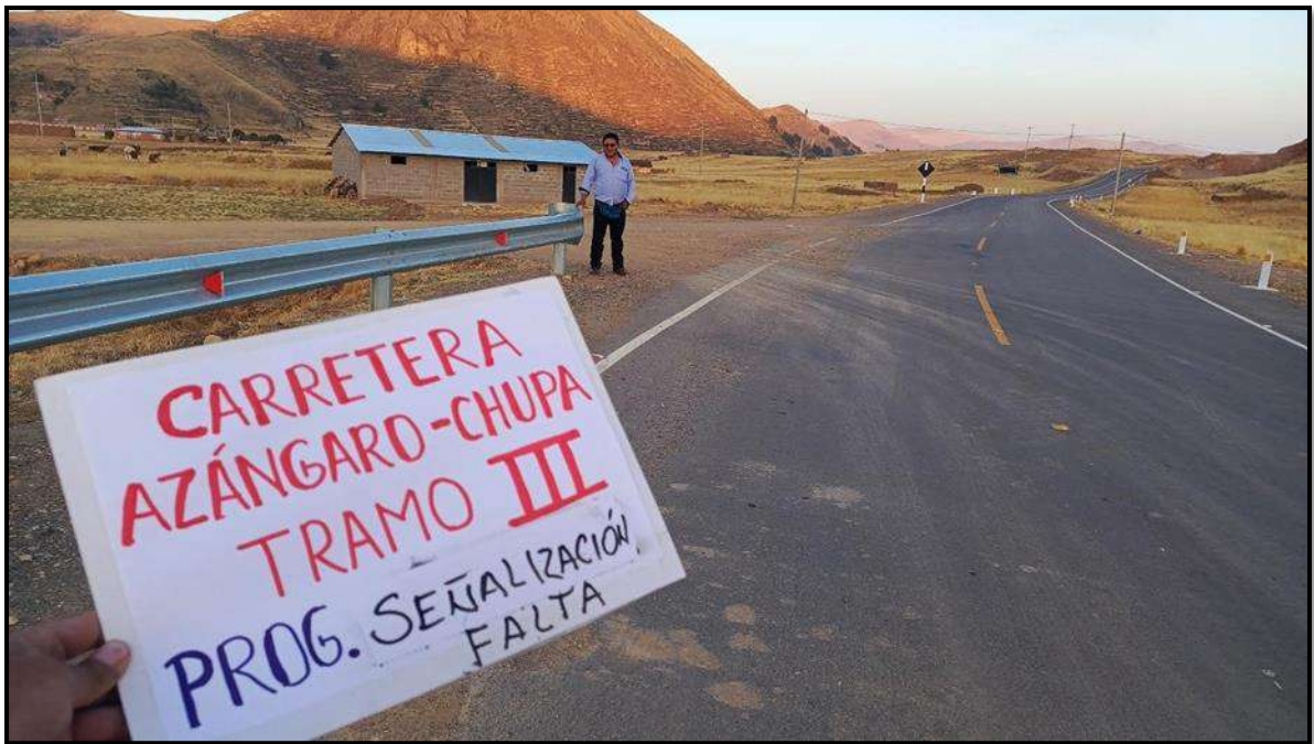
FOTOGRAFIA N° 19: EN LA IMAGEN SE MUESTRA LA AUSENCIA DE SEÑALIZACION DE PREVENCION (P-9B).
