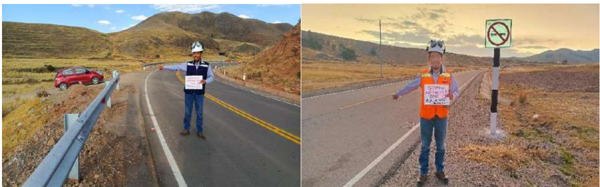
Figura 4. En la imagen se muestra la ausencia de señalización de prevención y reglamentaria en la progresiva km 21+560.
