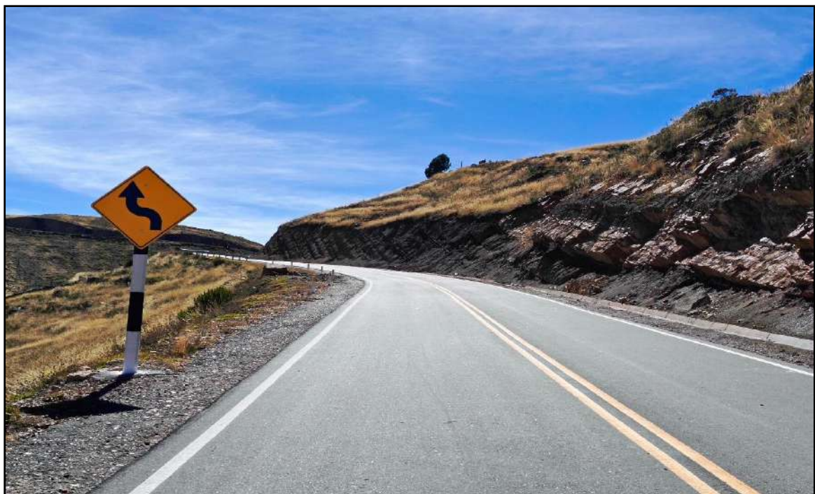
FOTOGRAFIA N° 06: EN LA IMAGEN SE MUESTRA EL INCUMPLIMIENTO DE LA LONGITUD MINIMA TRAZADOS EN "S" DE SENTIDO CONTRARIO EN LA PROGRESIVA 19+110.
