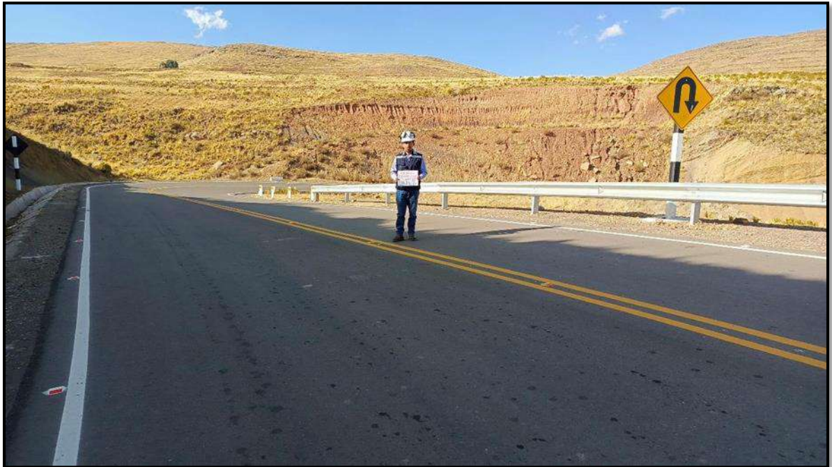
FOTOGRAFIA N° 05: EN LA IMAGEN SE MUESTRA LA AUSENCIA DE SEÑALIZACION INFORMATIVA (CURVA PELIGROSA) EN LA PROGRESIVA 18+260.
