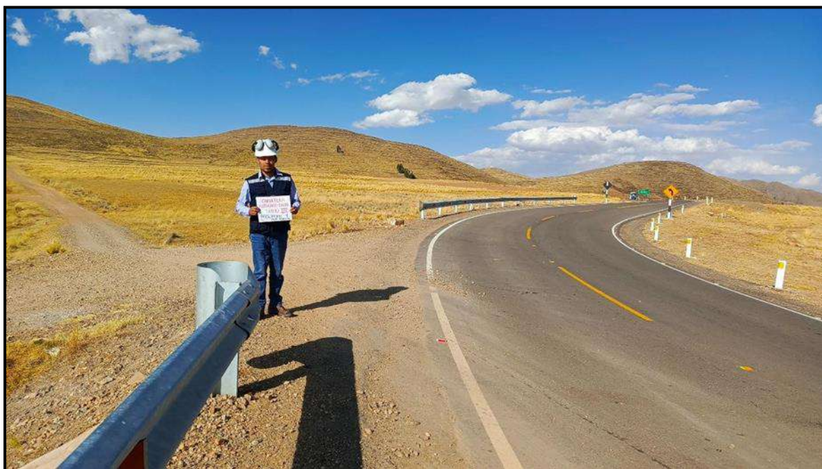
FOTOGRAFIA N° 04: EN LA IMAGEN SE MUESTRA LA AUSENCIA DE SEÑALIZACION DE PREVENCION (P-10B) EN LA PROGRESIVA 17+730
