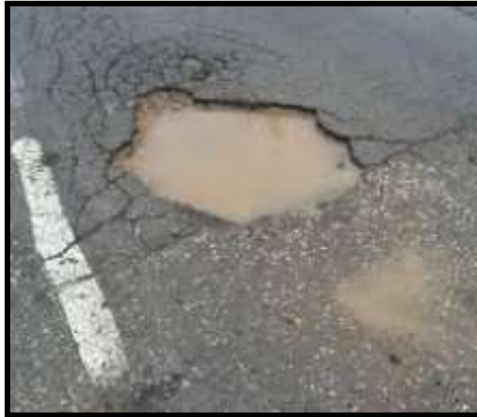
Figura N° 2-6 Baches en pavimentos flexible
