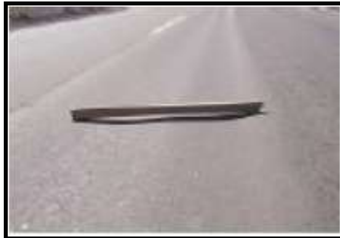
Figura N° 2-7 Falla por ahuellamiento
